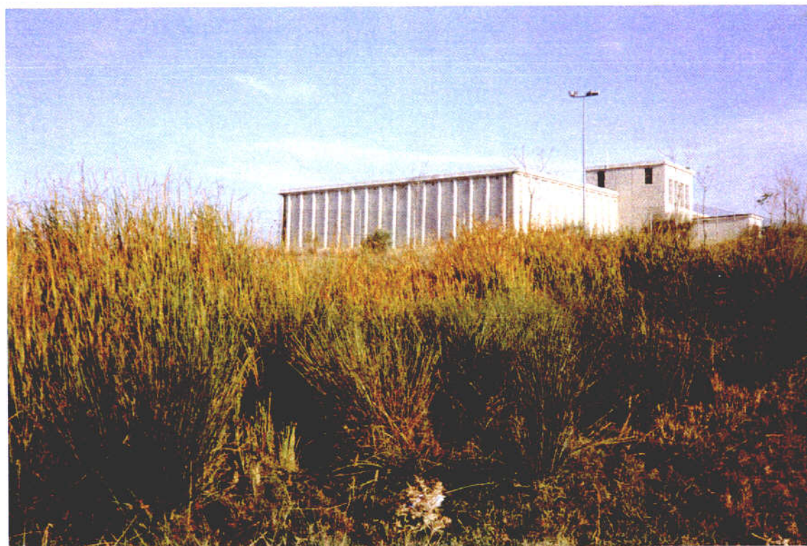
Foto 17. Detalle del depósito que presenta varias grietas con abundantes fugas de agua que forman un pequeño arroyo con desarrollo de vegetación de juncos etc.
