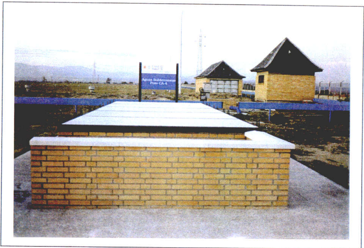
Foto 1. Vista del sondeo en el interior del depósito de El Goloso, en el extremo sur.
