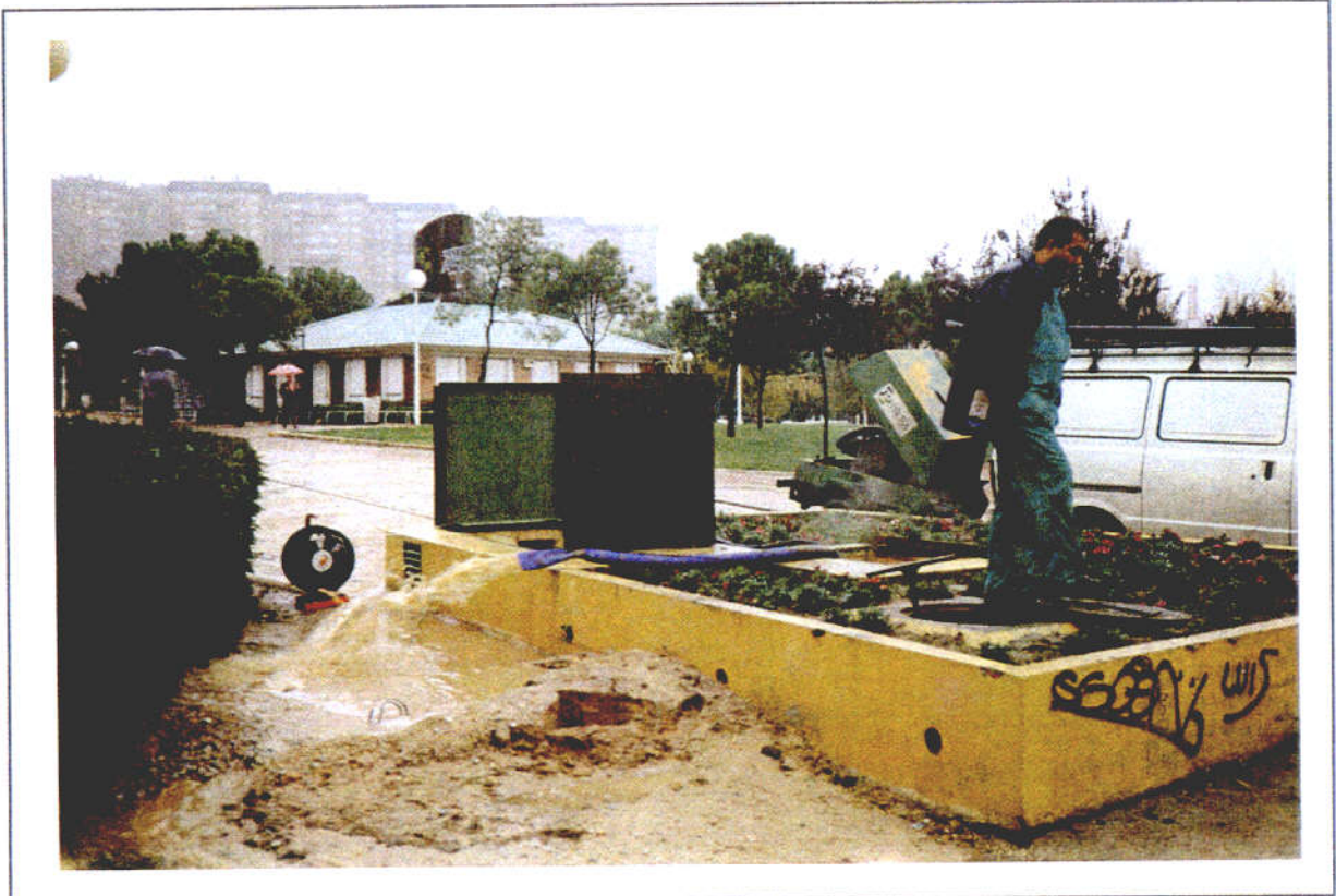
Foto 43. Situación del sondeo de la Vaguada el cual no pudo muestrearse por encontrarse inundada la arqueta de las llaves de paso. Los trabajos para intentar su puesta en funcionamiento fueron infructuosos.
